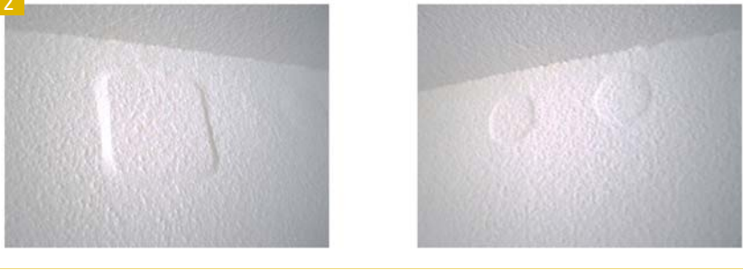
Abzweigdosen müssen zur Überprüfung zugänglich sein.
