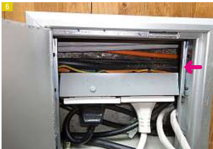
6 Einfach isolierte Drähte dürfen nicht berührt werden können, die Abdeckung ist zu klein!
