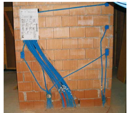
Kritische Leitungsführung, nicht normenkonform. Die Gefahr der Beschädigung durch Bohrarbeiten besteht!
