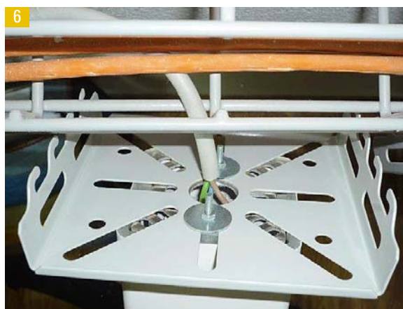
Montageplatte für Steckdose an Gitterkanal: – Zugentlastung genügend? – Berührungsschutz ausreichend? – Fehlerschutz entspricht NIN?
