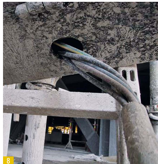
8 Sichtprüfung an Baustromverteilern.
