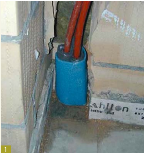
1 Leitungen aus dem Boden mit Schallelement umwickelt.
